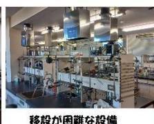
移設が困難な設備
